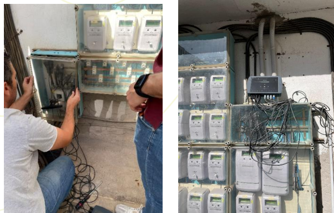
Figura 5. Instalación de analizadores de red
